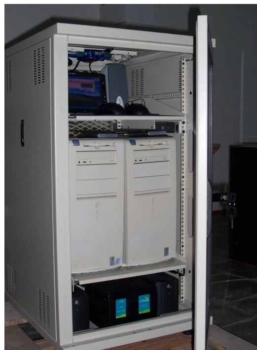
Sistema redundante en Gabinete con puerta de vidrio
